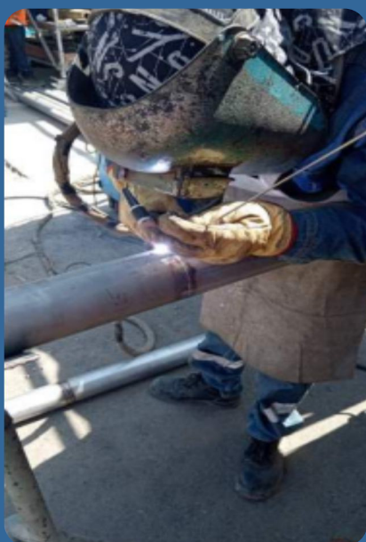
SERVICIO DE RENOVACIÓN DE TRONCALES DE VAPOR EN ENERGÉTICOS (ACERO INOXIDABLE) QROMA ÑAÑA
