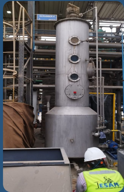
LAVADOR DE GASES
