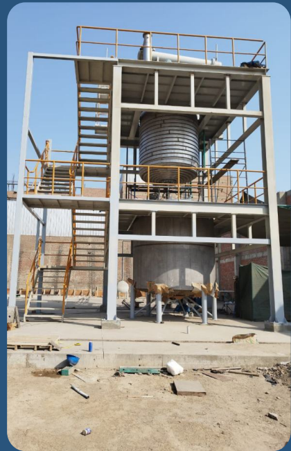
ESTRUCTURA CON VIGA H PARA REACTORES QUÍMICOS
