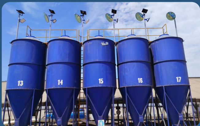
SERVICIO DE MEJORAR ESCALERAS PARA ACCESO A SILOS PCH07 SAN FERNANDO PLANTA CHILCA
